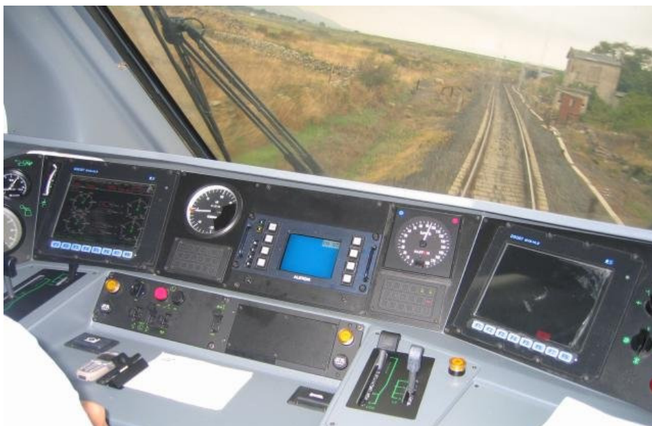
Figura 5.5-6: Treno Minuetto, cabina guida e console
