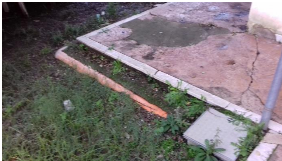
Figura 2 - Infiltrazioni di acqua sul marciapiede esterno e nella porzione interna
