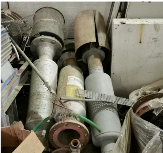
FILTRI PRESA ARIA COMPRESSORI
