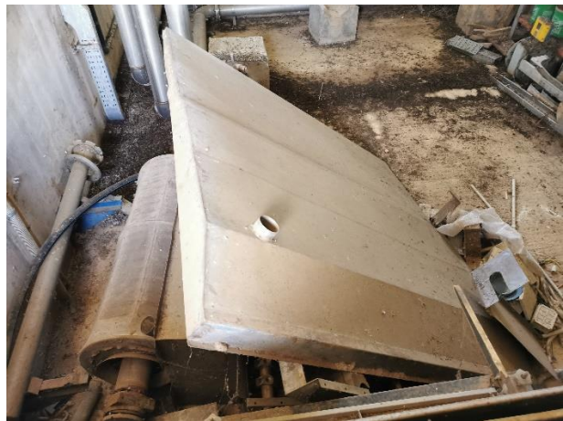
RACCOLTA ACQUE DI LAVAGGIO E ADDENSATORE FANGHI
